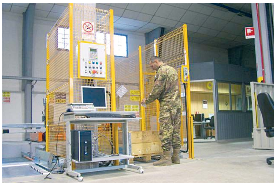
Il sistema automatizzato di movimentazione tra magazzino e sala spedizione
